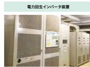
導入場所：羽田変電所
