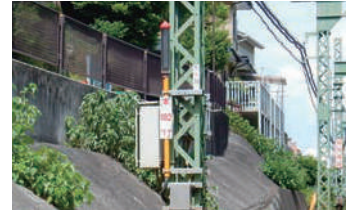
▲落石検知装置
