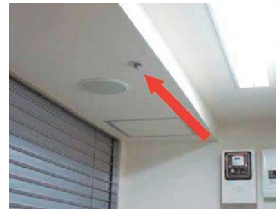
▲地下駅の火災対策「スプリンクラー」
